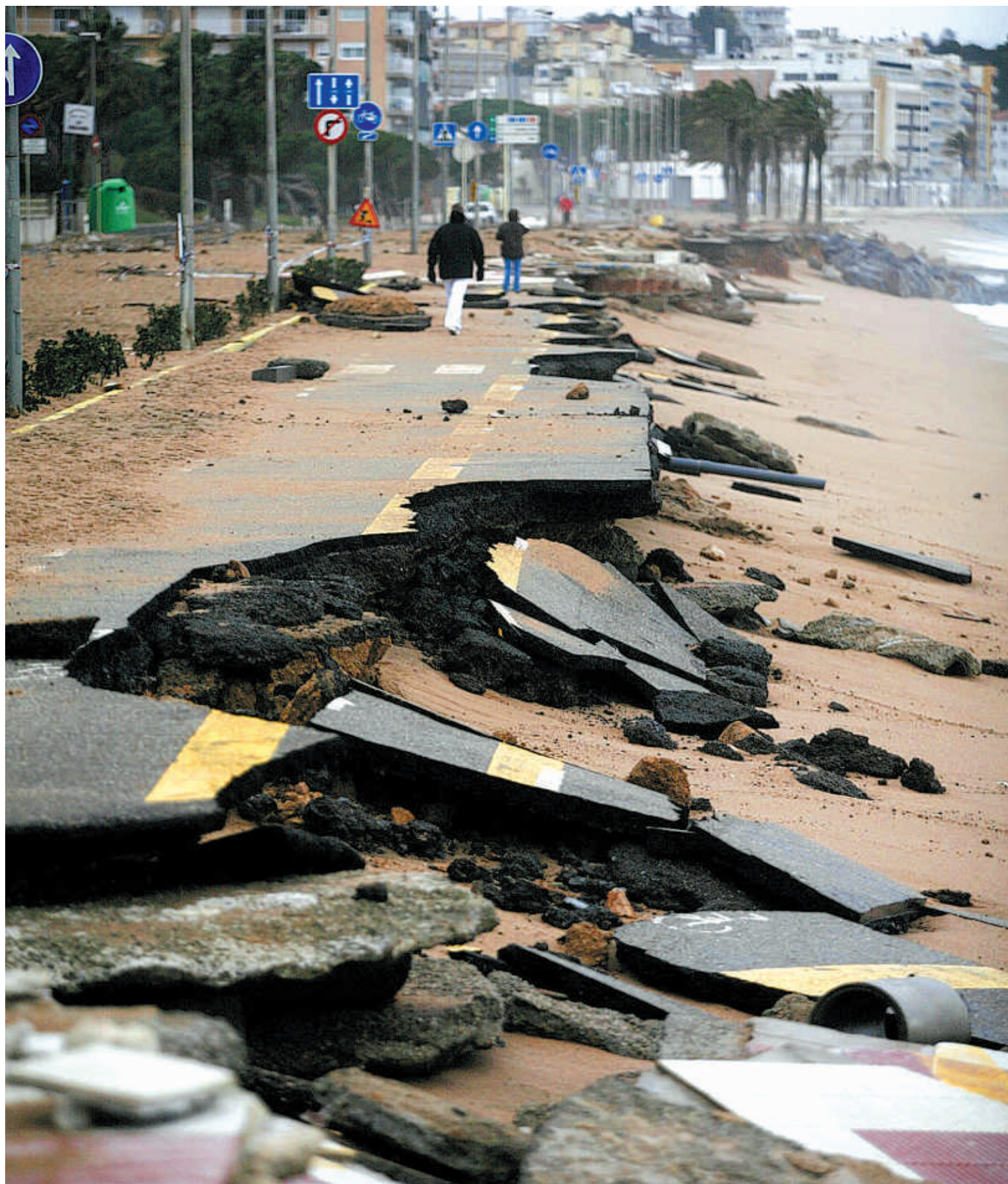
Esto fue un paseo. El mar enfurecido devoró la calzada de primera línea de mar en el municipio de Blanes
