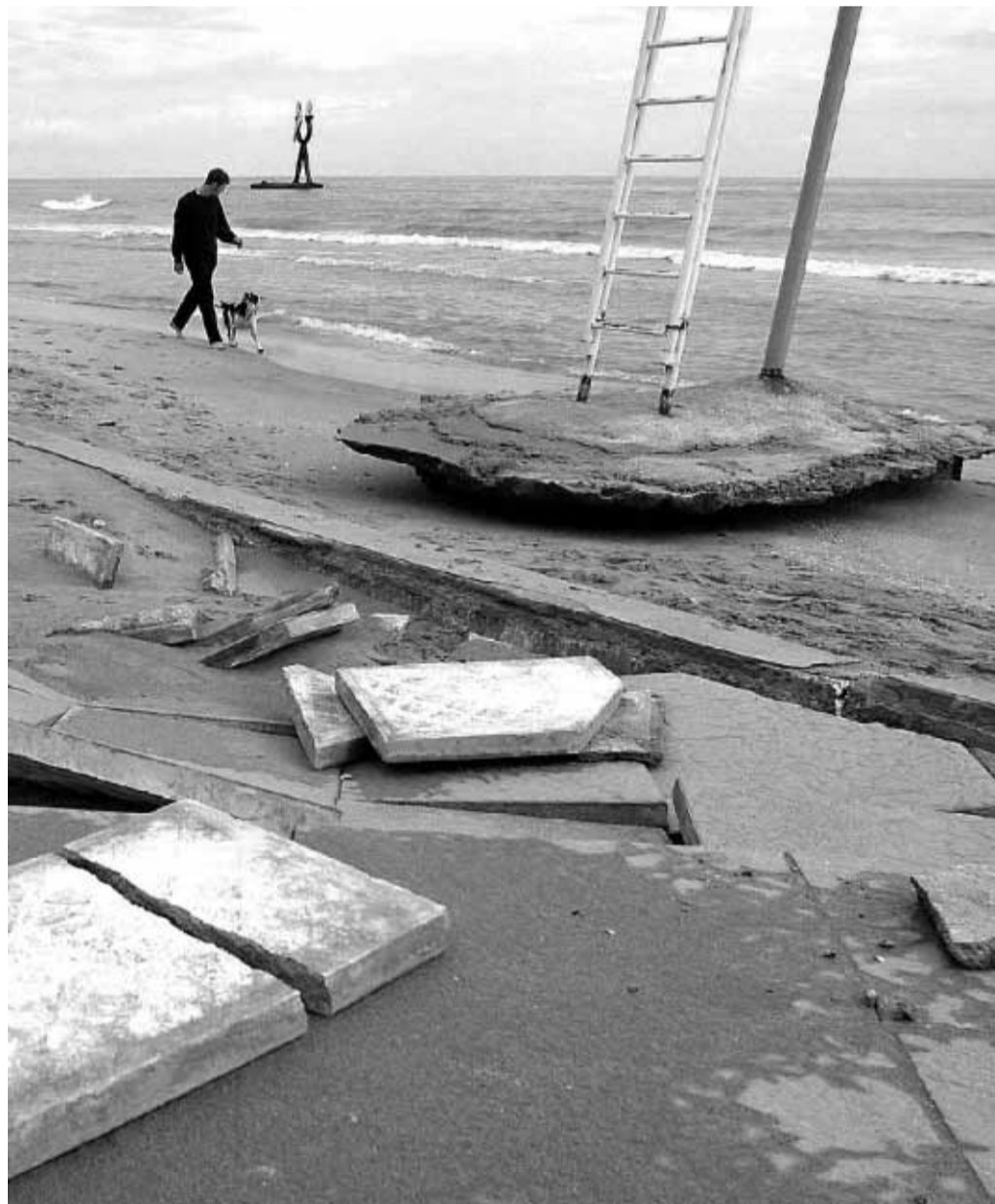
El fuerte oleaje arrancó los cimientos de varios tramos del paseo marítimo de Torredembarra
