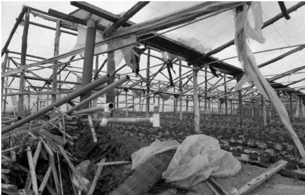
Los daños en los viveros del Maresme han sido cuantiosos y de una repercusión económica importante. En la foto, un invernadero de Vilassar de Mar
