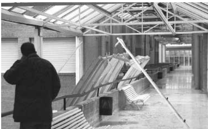
La caída de unos ventanales en la facultad de Ciencias de la Comunicación provocó el cierre de la UAB
