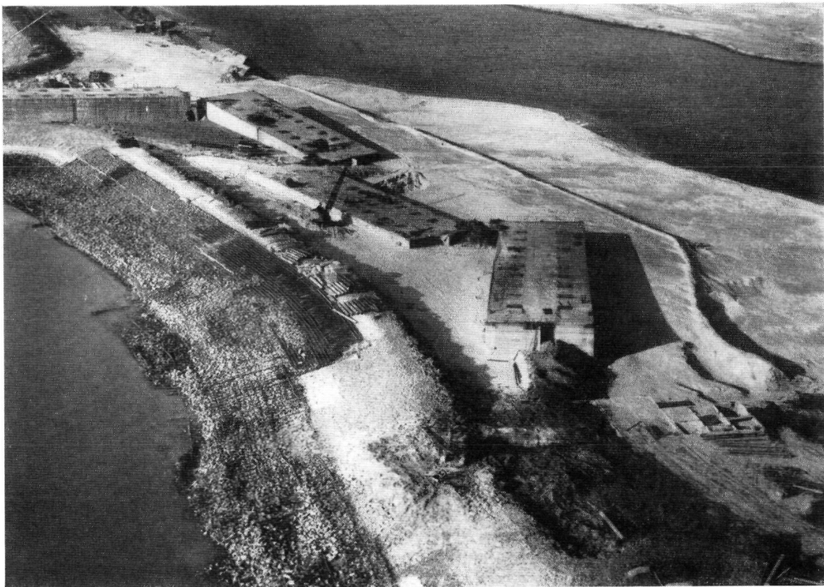
Fig. 4.126. Afwerking van de dijk ten zuiden van Ouwerkerk ter plaatse van de blokkering met vier Phoenixcaissons. Ten noorden van de caissondam is een breed strand gespoten. Aan de zuidzijde is op de kleibekleding een rijsbeslag met steen aangebracht.
