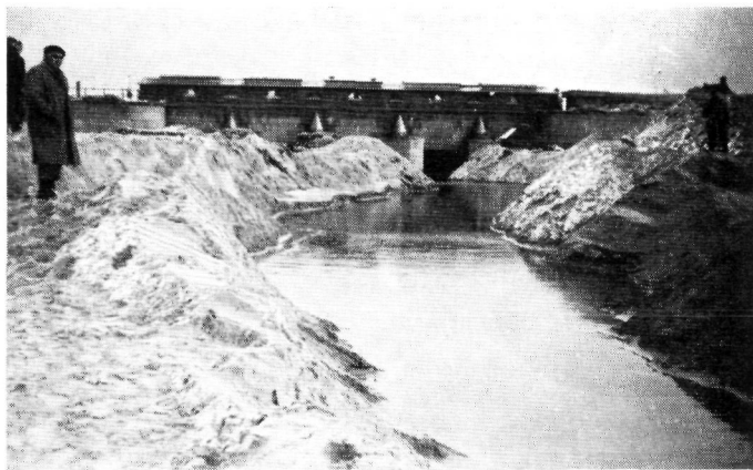
Fig. 4.37. Het uitdiepen van de met zand volgeslagen uitwateringsgeul van het gemaal te Katwijk
