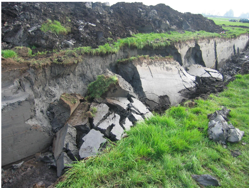
Foto 23: Het ingestorte geologisch profieldeel tussen 31 - 41 m. Het Ges-klei profiel is in dit deel onderuitgegaan omdat aan de linker zijde (31 – 36 m) deze klei lag op de Pleistocene ondergrond. Door grondwaterverplaatsing in het grensvlak vormde dit oppervlak een glijvlak.
